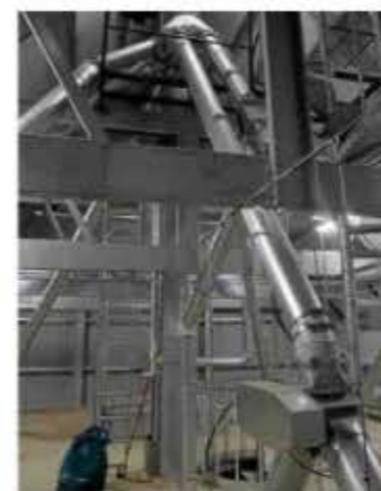
Torkanläggningen har en elevator och åttavägsfördelare.
