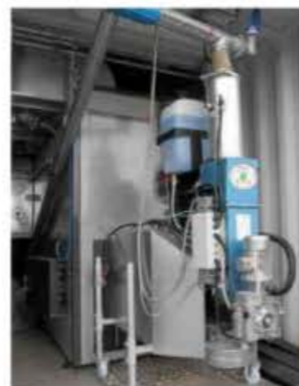
Container med 10 m 3 pelletsförråd och 450 kW panna från Vänerpannan, med brännare från Sonnys.
