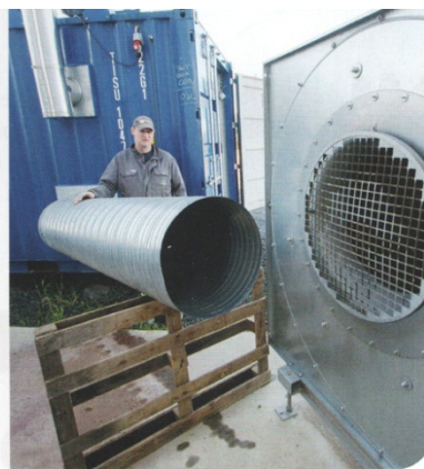
Pannfläkten blåser 12 000 kubikmeter luft i timmen och silofläkten blåser in 55 000 kubik.
