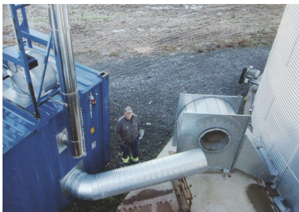
Det är bara att flytta pannans utblåsrör till rätt silo för att köra igång torkningen. Enkelt och funktionellt.
